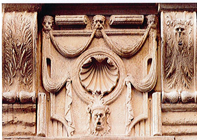
Élément de la façade à remplacer
